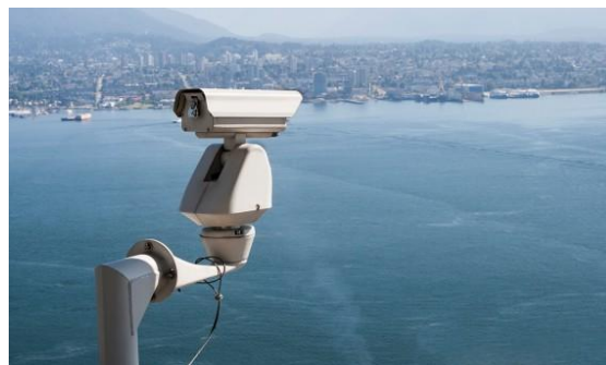
Figura 10. Circuito Cerrado de Televisión
