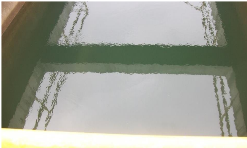
Foto #2. Filtración de arena
