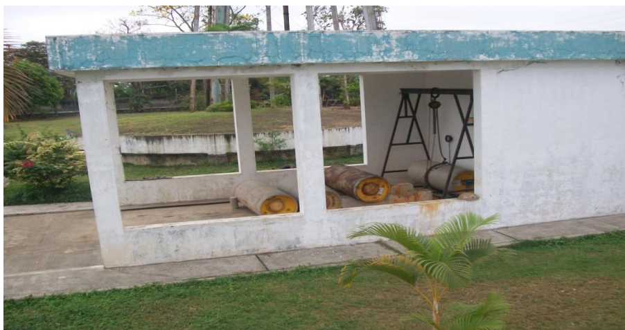
Foto #3. Bombas mezcladoras de cloro
