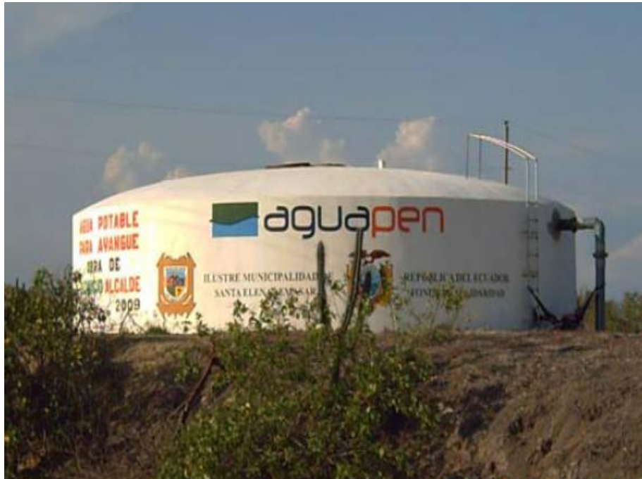
Reservorio de Agua Potable para abastecimiento de Ayangue (Aguapen).
