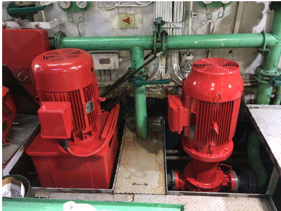
Ilustración28: Sistema contra incendios del BT Jambelí
