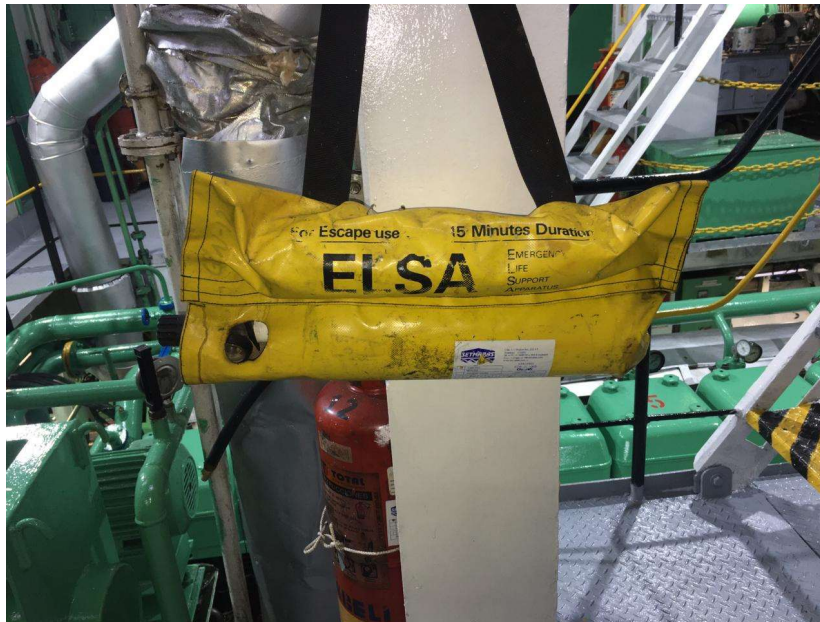
Ilustración 23: Parte del sistema contra incendios
