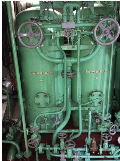
Ilustración 21: Botellas de aire de la sala de máquinas
