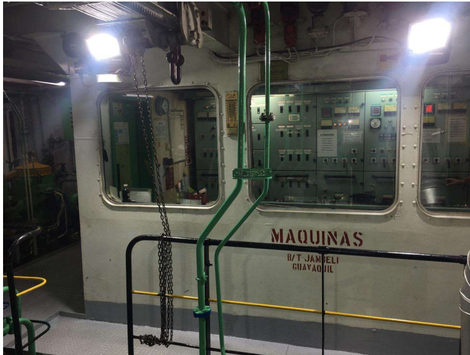
Ilustración 19: Exterior de la consola de máquinas
