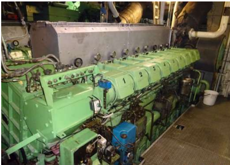
Ilustración 10: Motor SBV 9M-628 dentro de sala de máquinas
