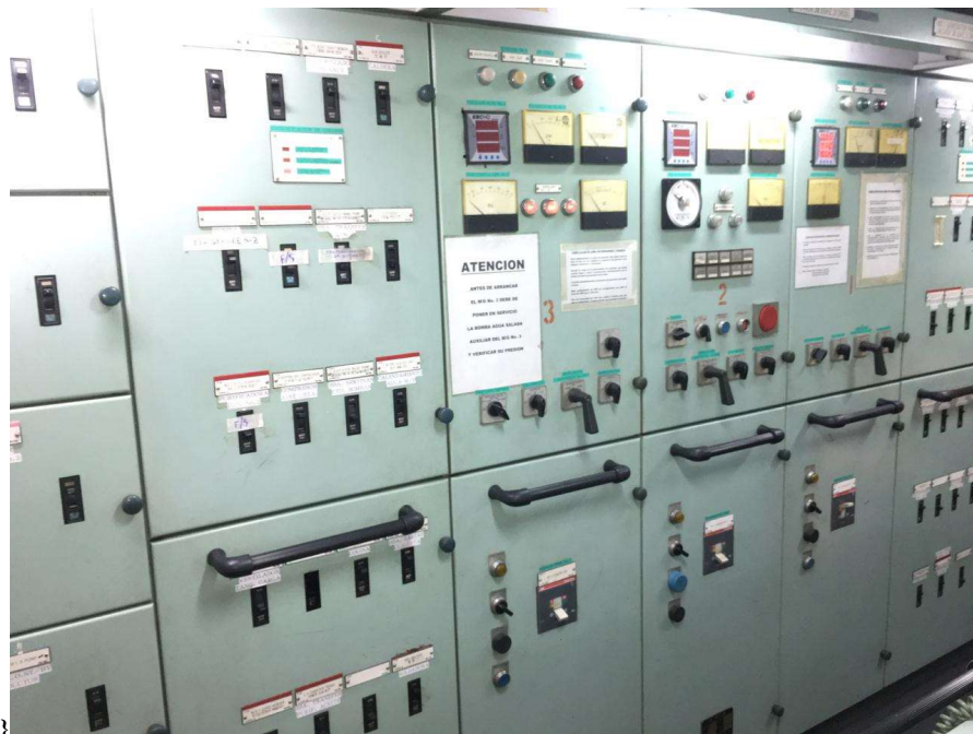
Ilustración45: Señalética dentro de la cabina de máquinas del BT Jambelí
