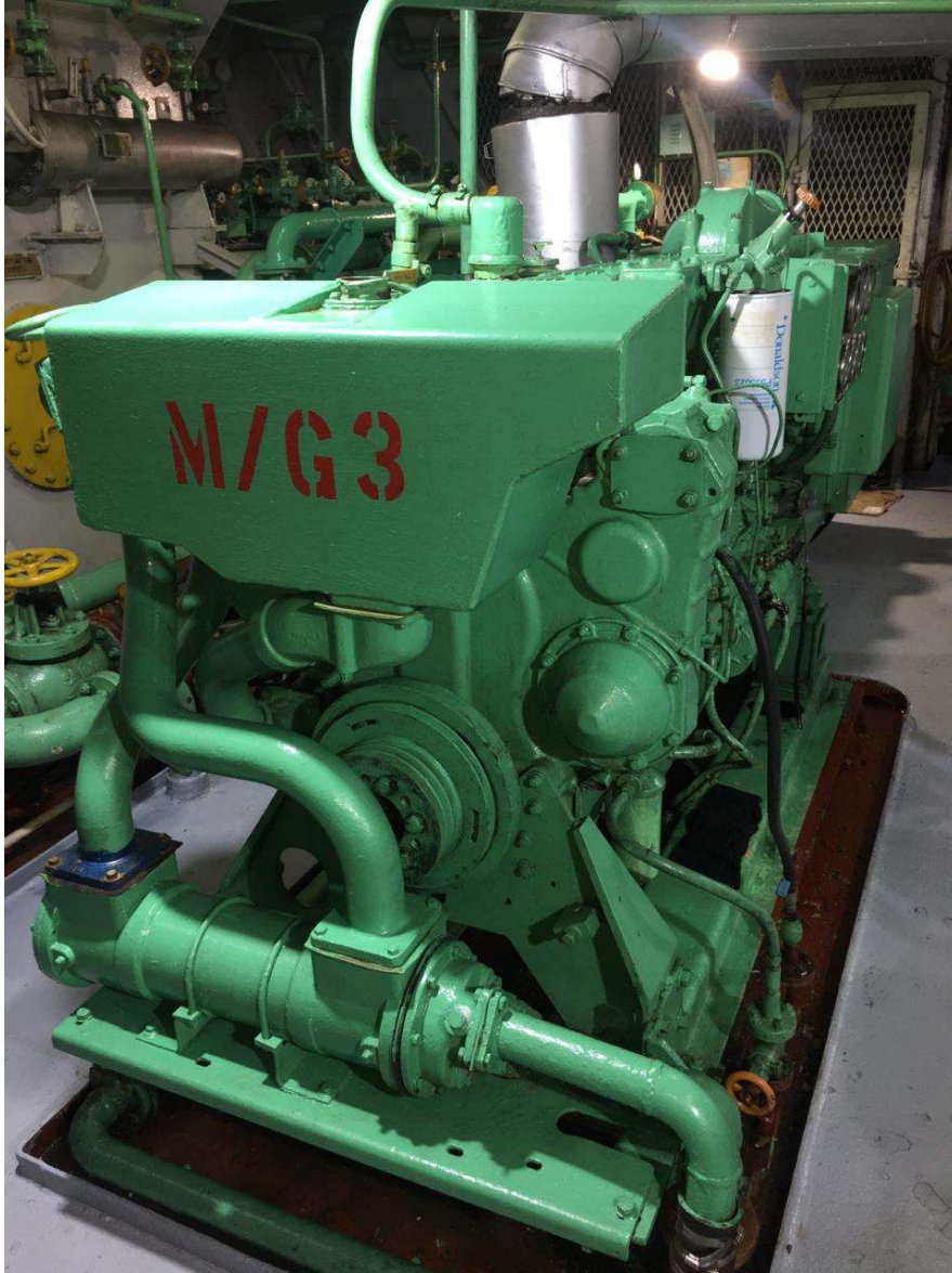
Ilustración26: Motor generador 3 del BT Jambeli
