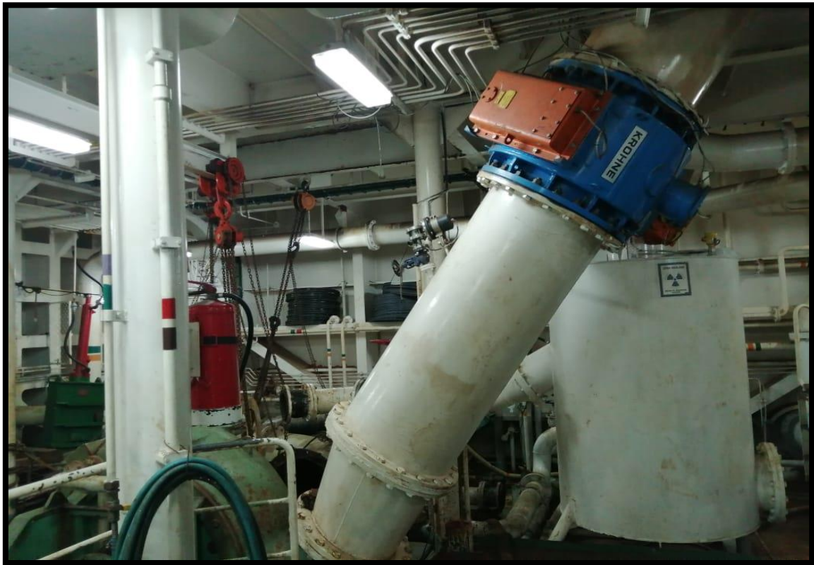
Figura 25: Sala de Máquinas de Buque Draga
