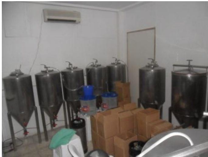
Figura 32 Fermentadores y maduradores de acero inoxidable
