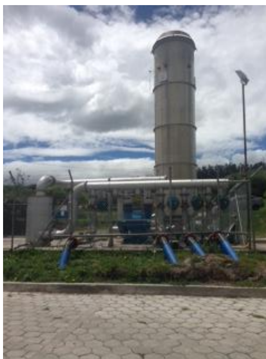
Figura No. 26 Planta de incineración de biogás Relleno Sanitario El Inga
