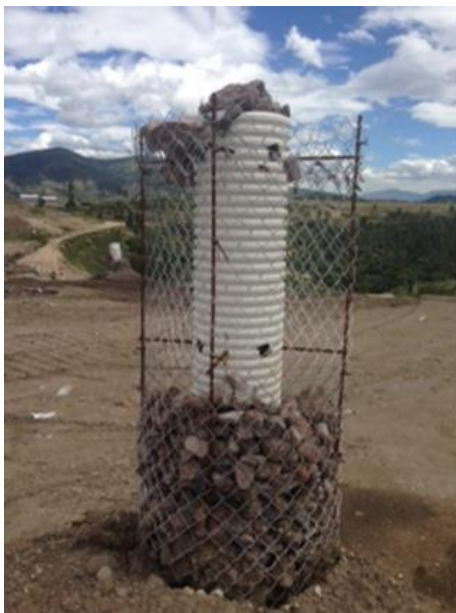
Figura No. 24 Chimenea de ventilación de biogás Relleno Sanitario El Inga
